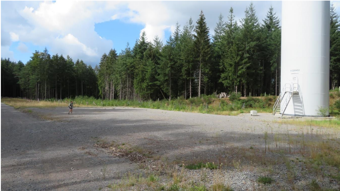
Bild 6: Geländemodellierung für Windkraftwerk (3,3 MW p 19 ) auf dem Gipfel des ursprünglich dicht bewaldeten Stillfüssels südlich Waldmichelbach
